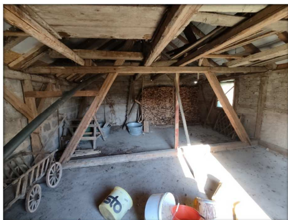
Speicher im Nebengebäude
